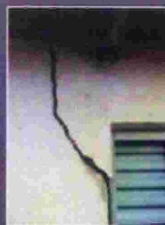
Novas trincas nas paredes
