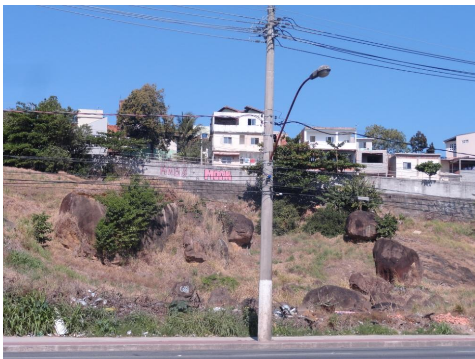
Figura 10 – Blocos e matações com possibilidade de movimentação. É importante ressaltar que estas movimentações, a princípio não causarão problemas nem para a Av. Fernando Ferrari nem para as moradias a montante. Porém, é importante não modificar a geometria do terreno.
