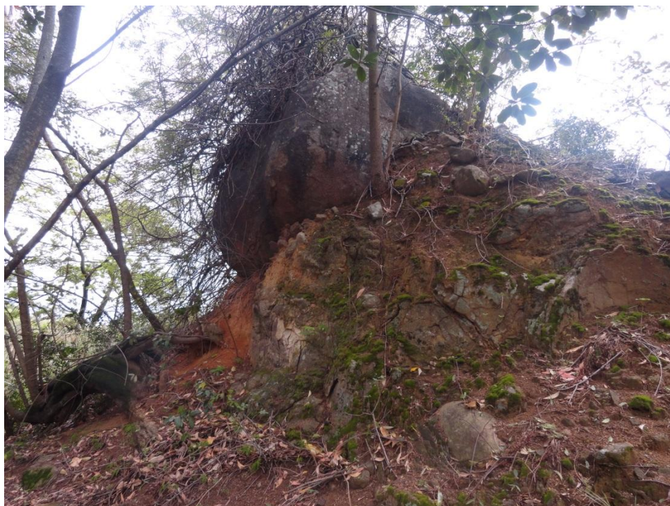
Figura 39 – Vista frontal do bloco instável na crista do talude.
