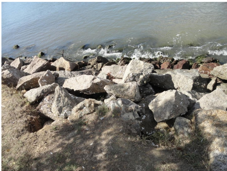
Figura 33 – Em destaque exemplos de erosão que ocorrem ao longo do aterro por trás do enrocamento.
