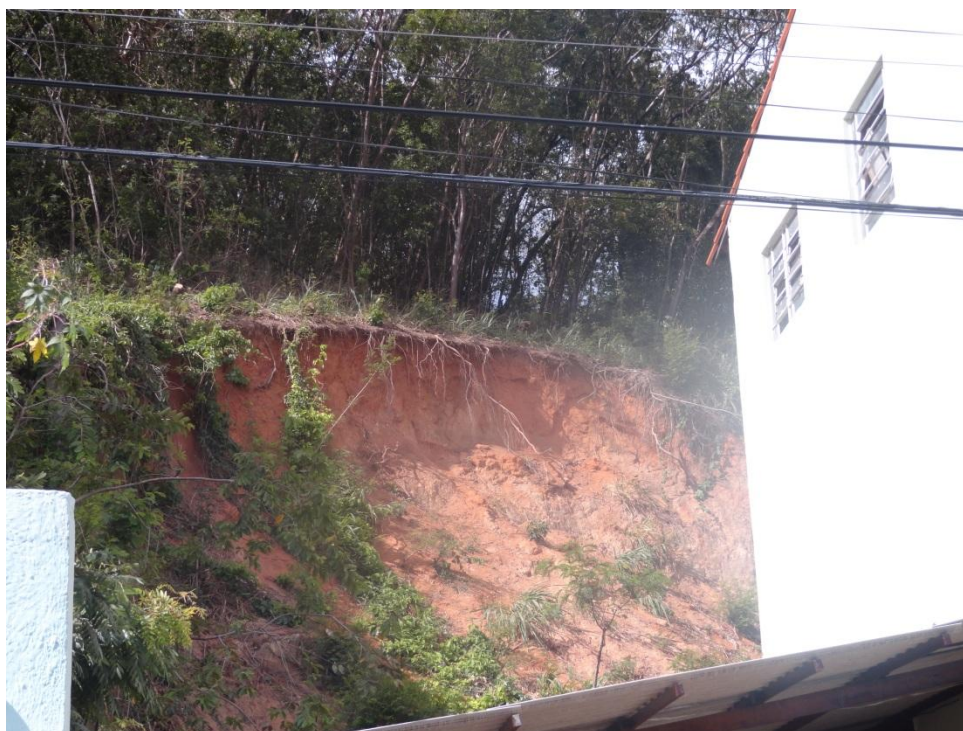
Figura 26 – Detalhe da erosão, com árvores de grande porte inclinadas na crista do talude.
