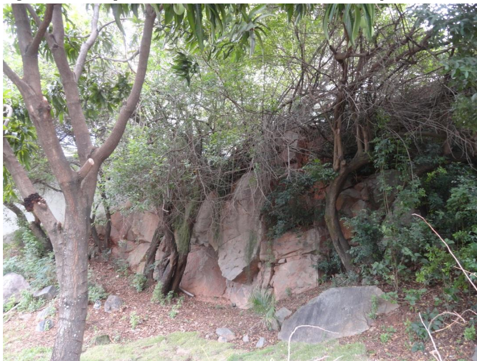
Figura 37 - Área próxima ao estacionamento com risco de queda de blocos.
