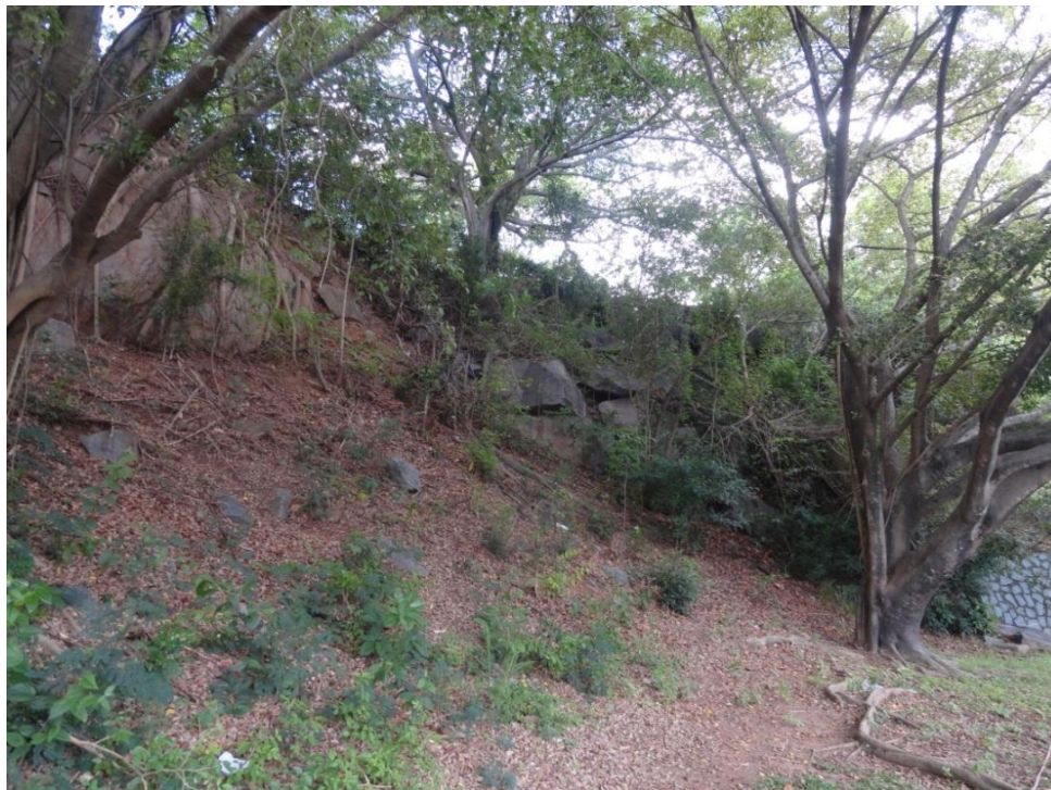
Figura 36 – Área próxima ao estacionamento com risco de queda de blocos.
