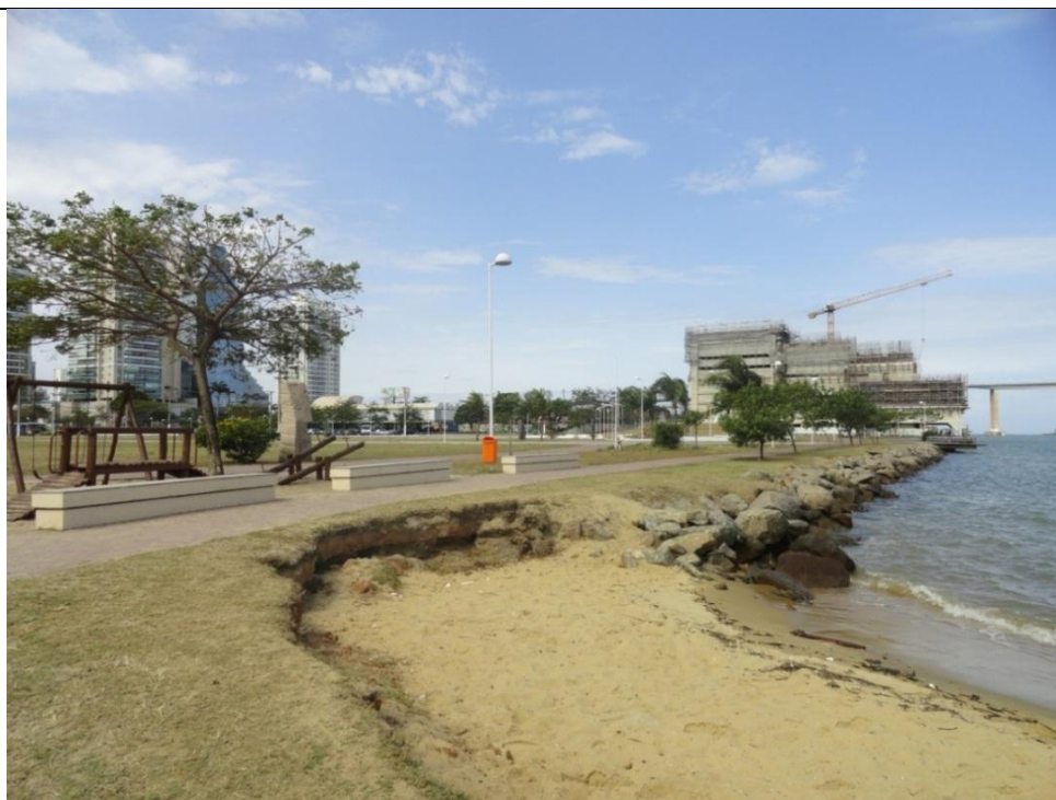
Figura 32 – Vista da área costeira com erosão já chegando à área da praça. É importante ressaltar que em dias de chuvas fortes ou elevação da maré, a praça fica alagada.
