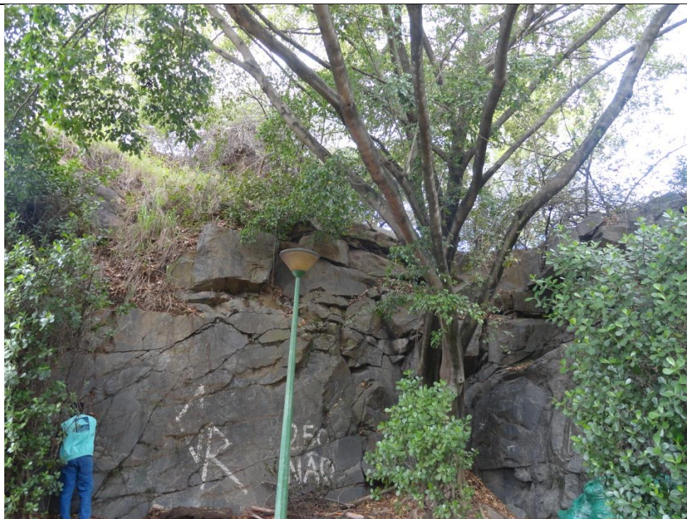
Figura 38 – Afloramento rochoso muito fraturado, individualizando blocos que poderão afetar o vestiário do parque.
