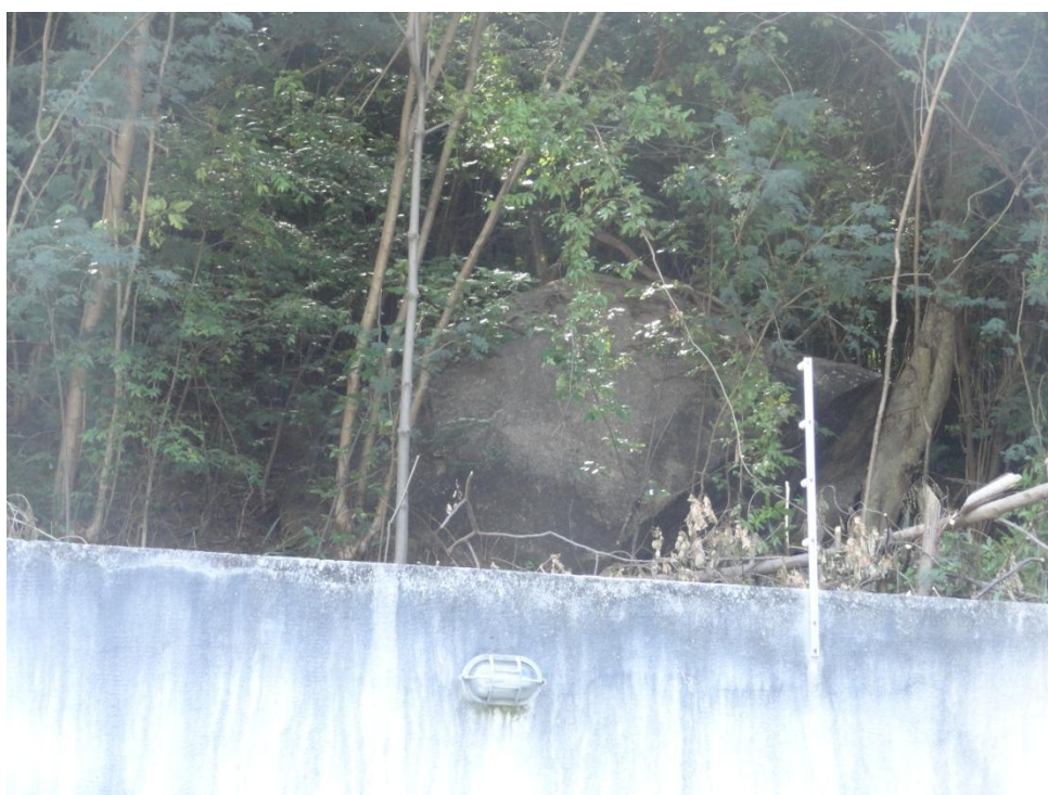
Figura 29 – Vista de blocos sobrepostos na matriz de solo, muito próximo as moradias.
