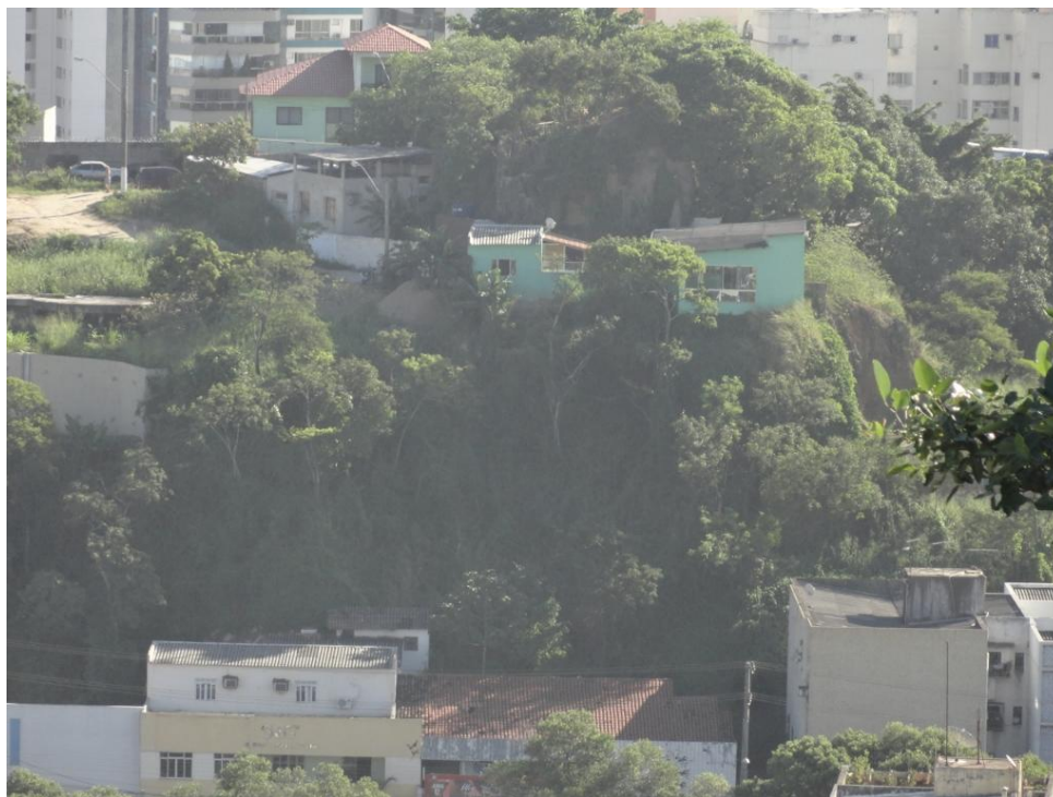
Figura 19 – Vista para parte do talude que ainda apresenta risco.
