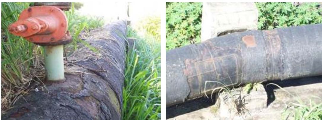
Figura 18: AAT-DN800-Aço ETA Cobi x Vitória– trecho 1: estado de deteriorização da tubulação em aço.
