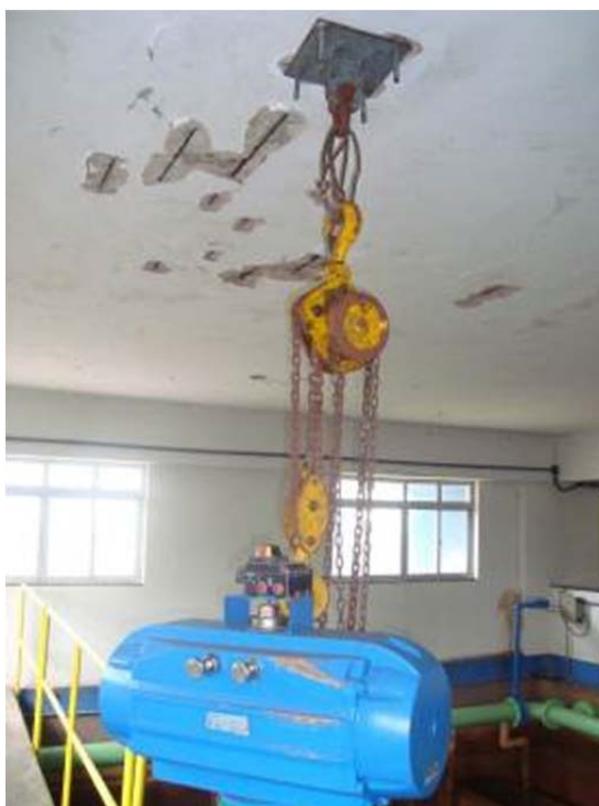
Figura 17: Perda de cobertura e corrosão da armadura do teto.
