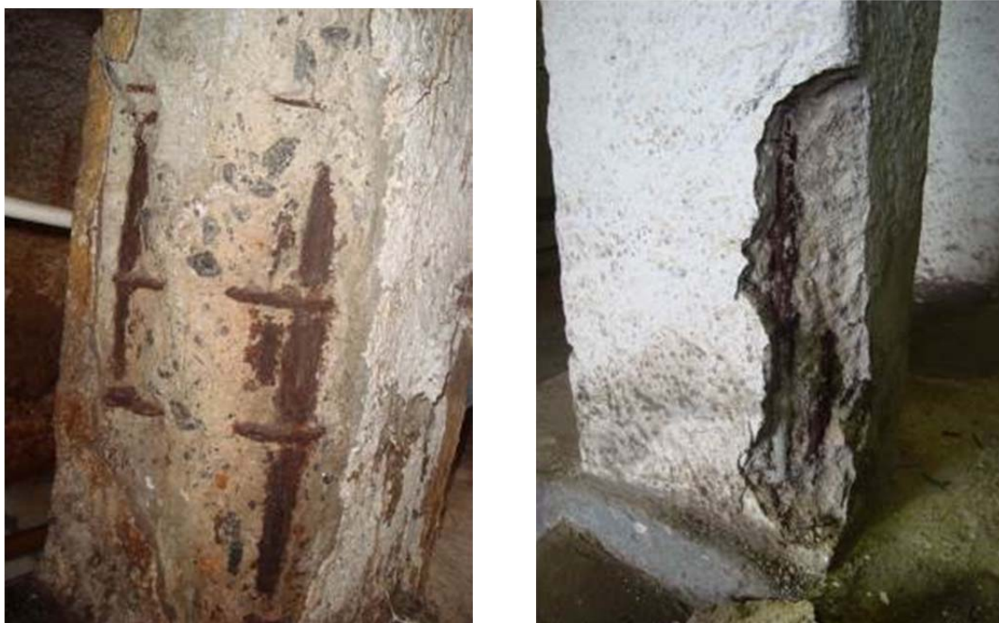
Figura 16: Pilar com armadura aparente.
