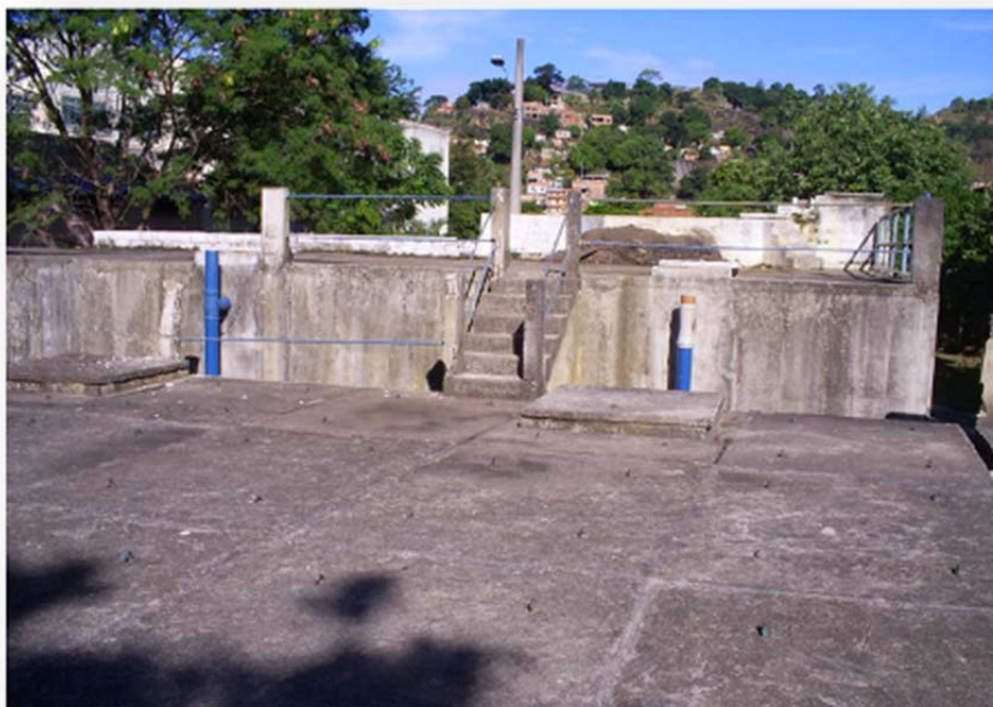
Figura 32: Estação de tratamento de esgoto Nova Palestina.
